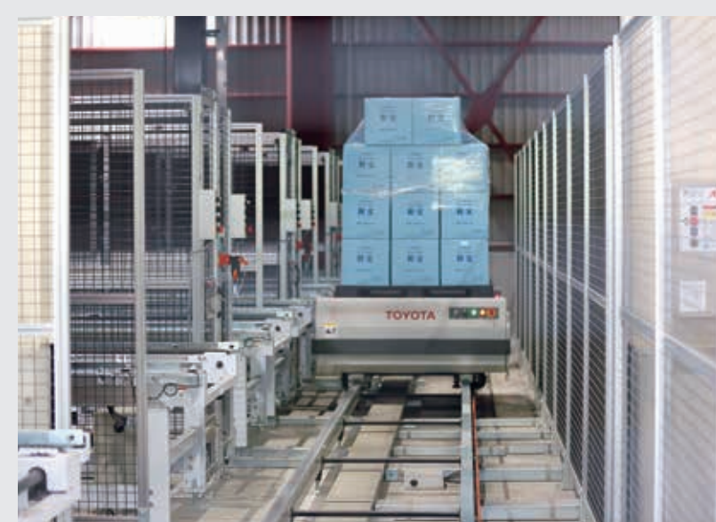
[工場]→[倉庫]搬送 モービルソーターで工場・自動倉庫間を搬送。
