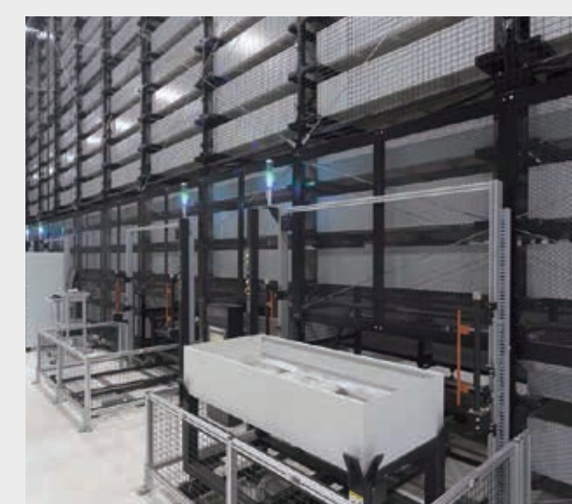
⑧小型長尺自動倉庫
